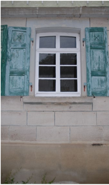
Abb. 1: Fensterladen mit Kotresten auf dem Mauerabsatz rechts unten
